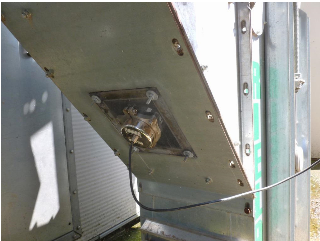
Bild 2: Sensor am Trocknereinlauf und -auslauf
