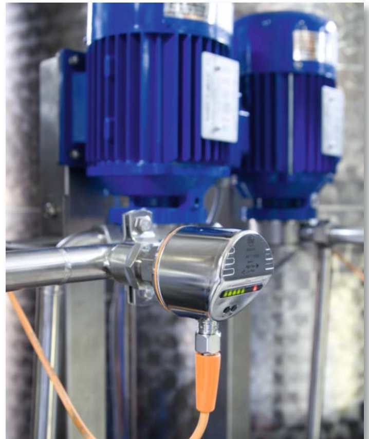
Ein Strömungssensor kontrolliert hinter den Pumpen den Zufluss der Reinigungsflüssigkeiten.
