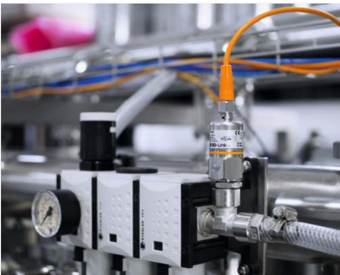
Ein Drucktransmitter überwacht das „Leerdrücken“ der Anlage mittels Druckluft
