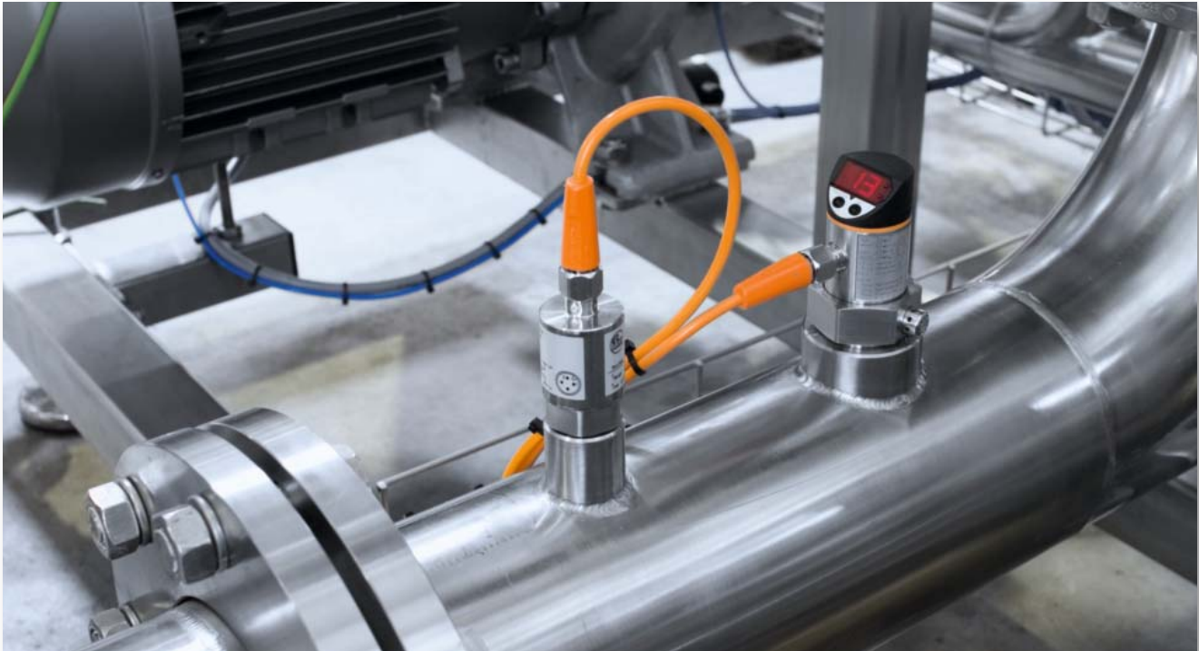
Zufluss überwachen: Temperaturtransmitter und Drucksensor in der Anströmleitung.
